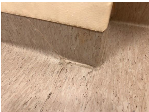
Slitasje på sveis skjot gulvbelegg.
