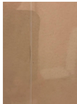
Svikt i vertikal sveiseskjøt til veggvinyl.
