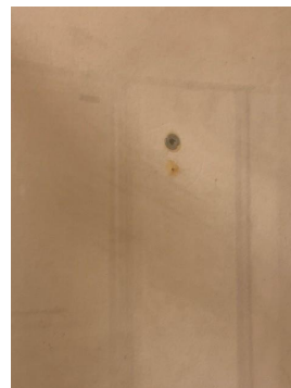
Diverse huller i veggvinyl i dusjsone.
