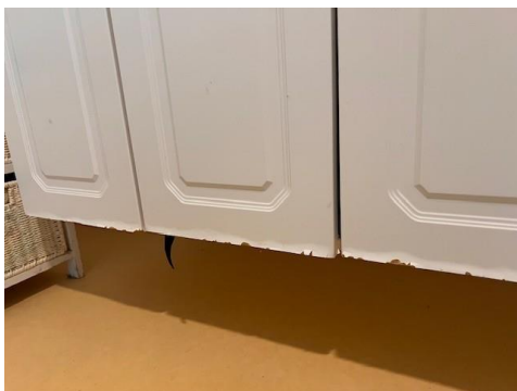
Fuktskader på Innredning.
